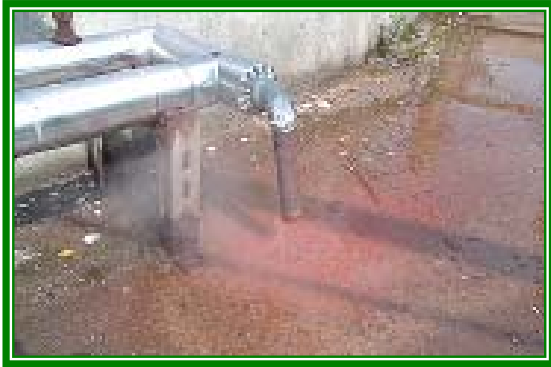
石化儲槽日常操作區
