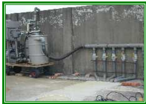
加油站 SVE 回收設備
