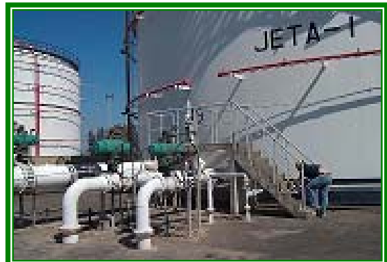
儲槽管線出入口
